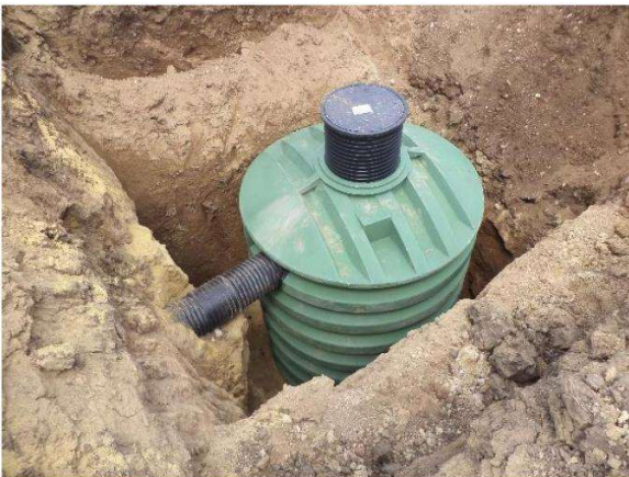
6. sz. Kép: Telepített tartály
